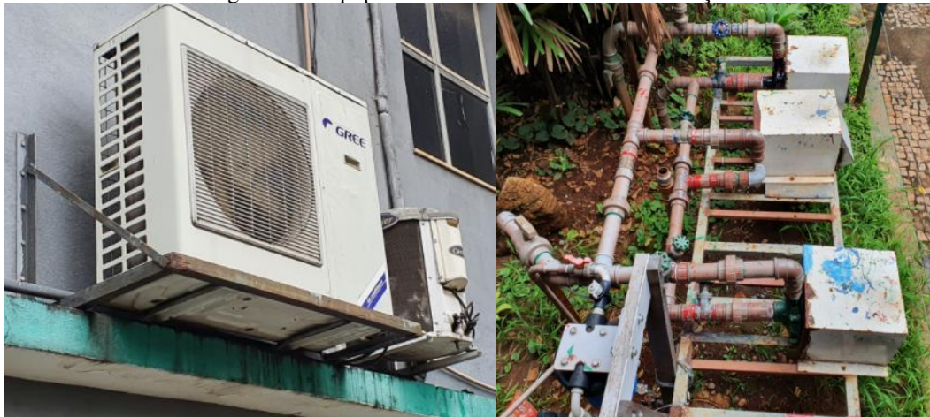
Figura 20 - Equipamentos ruidosos no local de medição
